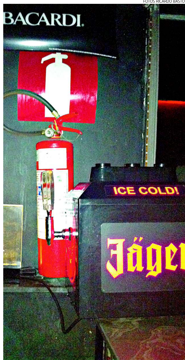
SAVASSI - Máquina de bebidas dificulta o acesso ao extintor de incêndio, colocado em uma altura indevida
